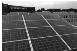
屋上に取り付けられた太陽光パネル
