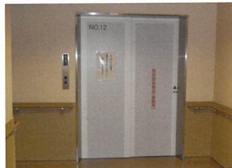
救命センター・手術室と 直通の専用エレベーター
