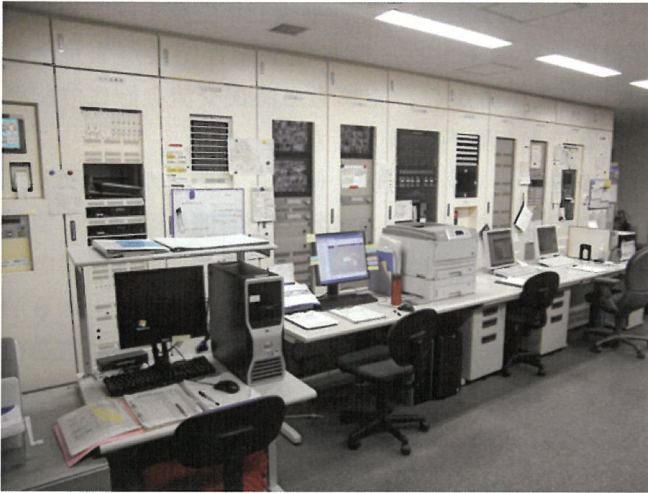
防災センター室内
